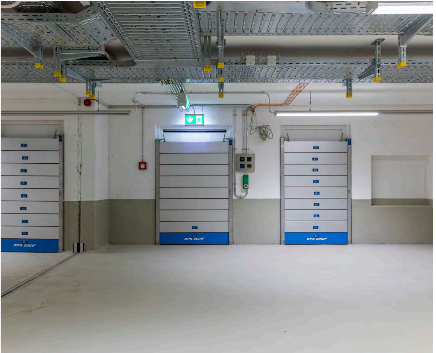
Die Hochwasserschotts in der Tiefgarage
