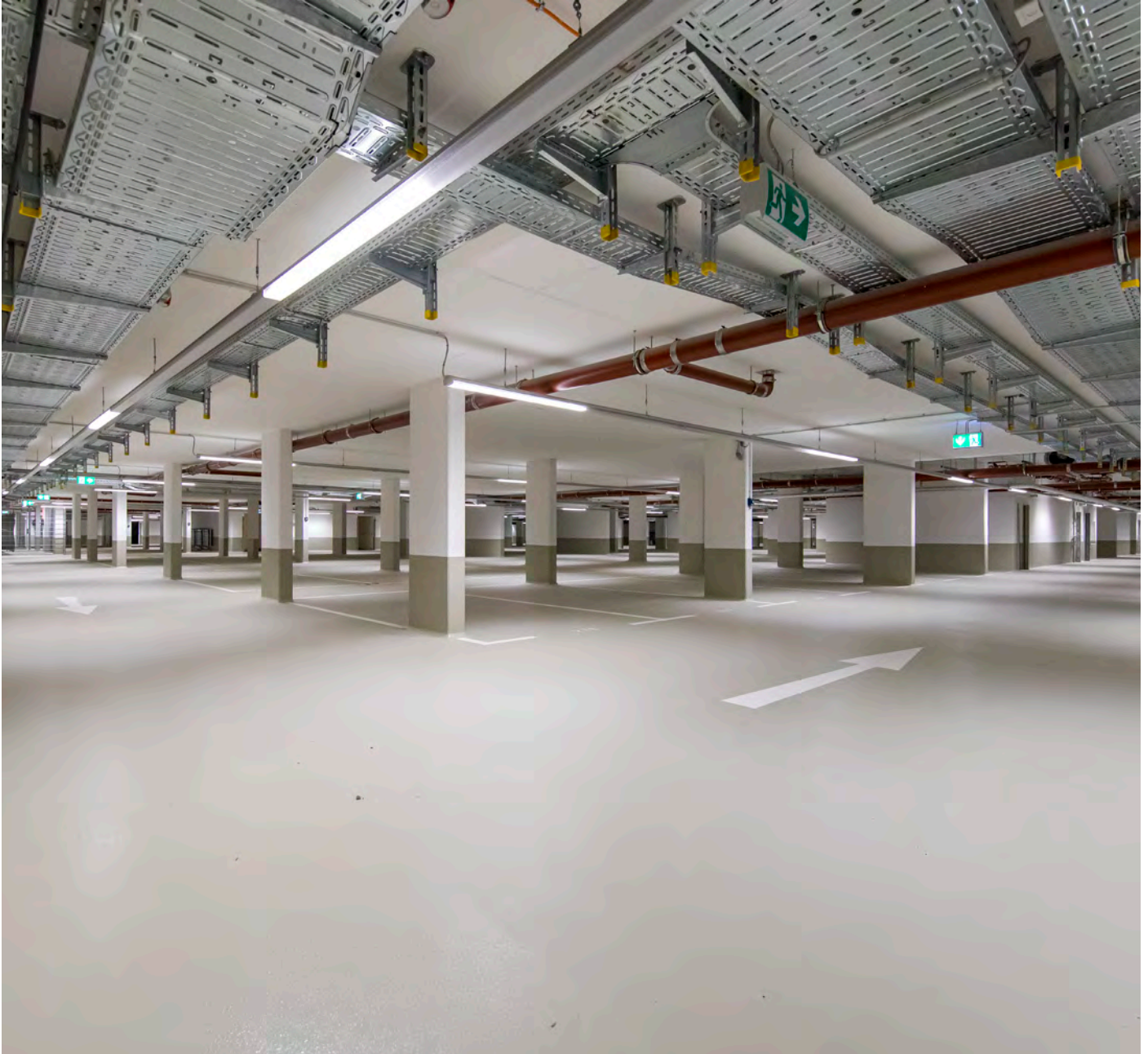
Die Tiefgarage mit Kabeltrassen
