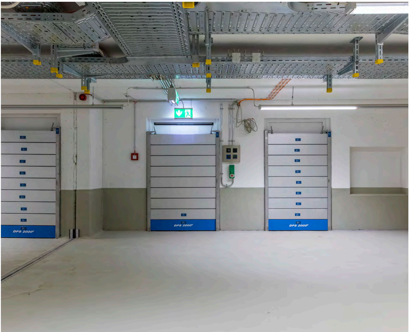
Die Hochwasserschotts in der Tiefgarage
