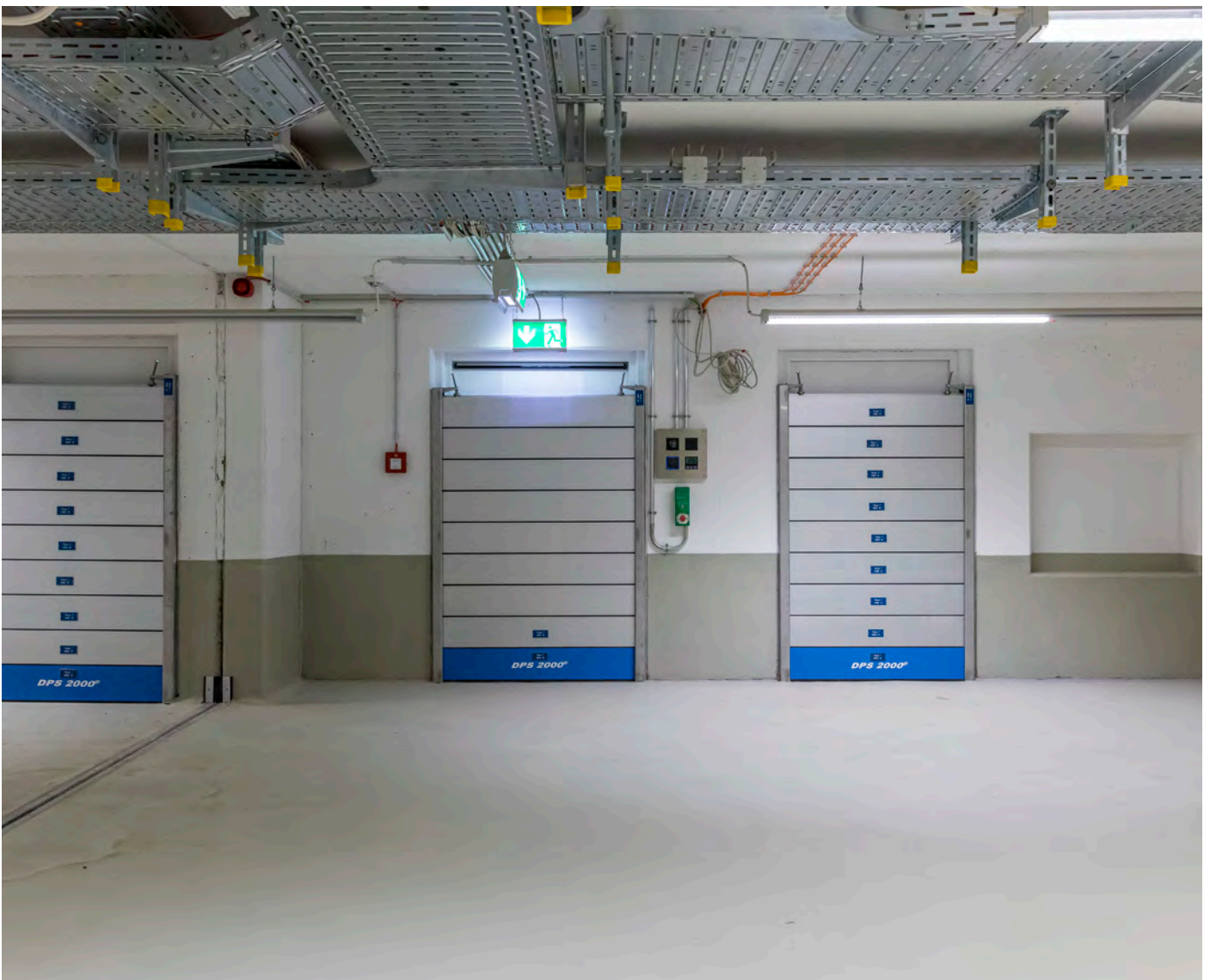
Die Hochwasserschotts in der Tiefgarage
