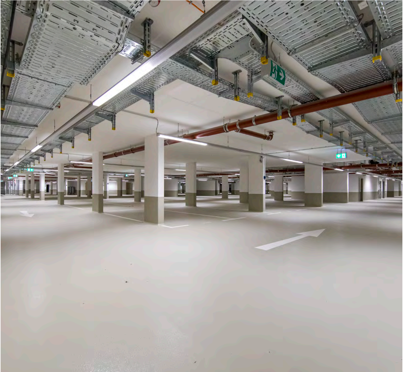
Die Tiefgarage mit Kabeltrassen
